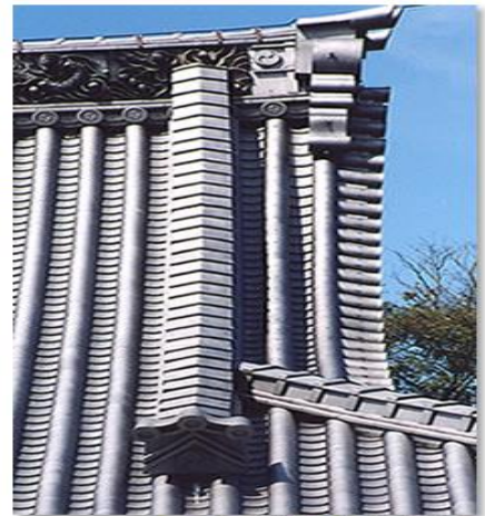
写真◎ 破風板の転びが大きい
